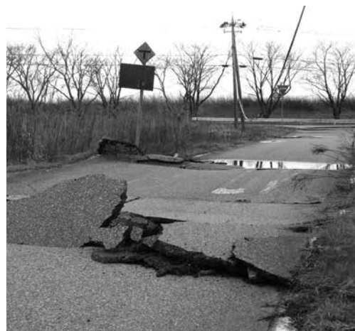
亀裂が入った河北潟の道路
