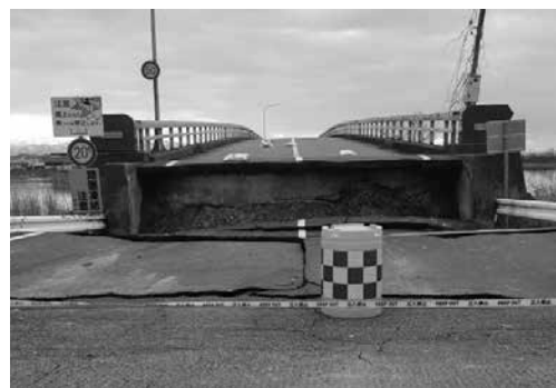
地盤沈下により寸断された才田大橋
