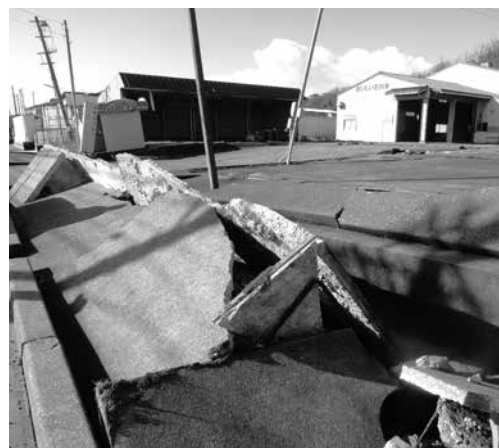
隆起・横ずれにより崩壊した歩道
